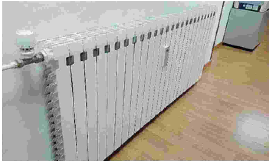
Un calorifero con i più recenti dispositivi di termoregolazione e contabilizzazione del calore./ METRO
