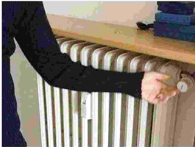
La termovalvola montata in un appartamento servito dal teleriscaldamento
