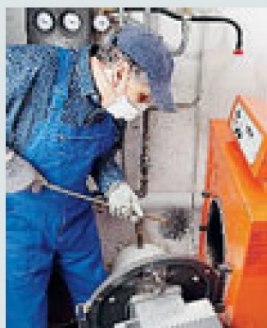
Controllo caldaie. /OLYCOM
